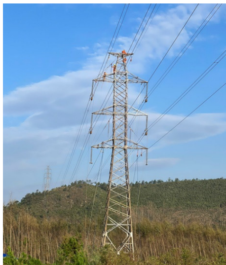
Hình 2. Đường dây hai mạch 220kV hai mạch
