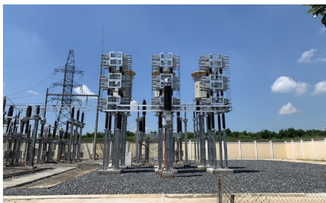
Hình 1. Giàn tụ bù tại TBA 110kV Bắc Á [4]
