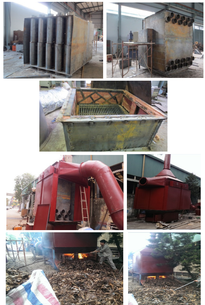
Hình 5. Một số hình ảnh về kết quả chế tạo, lắp đặt và đốt lò chạy chưa có tải (chưa kết nối với máy sấy)
