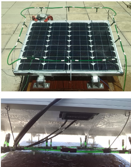
Hình 12. Làm mát tấm PV bằng phun nước lên bề mặt trước và sau tấm PV [42]
