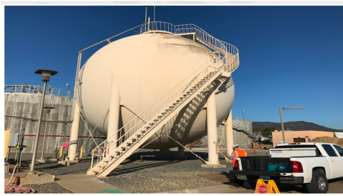
Hình 1. Hệ thống bồn chứa ga có kích thước lớn [1]
