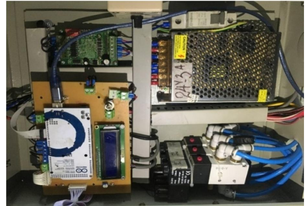
Hình 9. Hệ thống các thiết bị trong tủ điện
