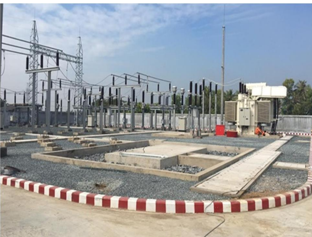
Hình 1. Trạm biến áp 110/22 kV Tầm Vu
